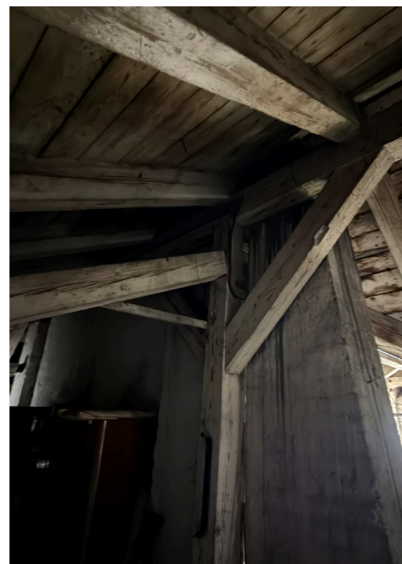
Technicky nevyhovujúci krov
