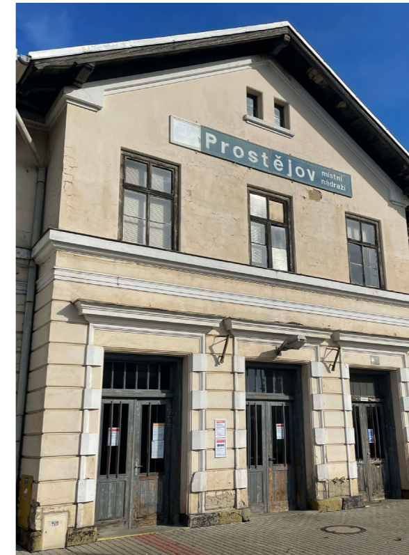
Technicky nevyhovujúce výplne otvorov
