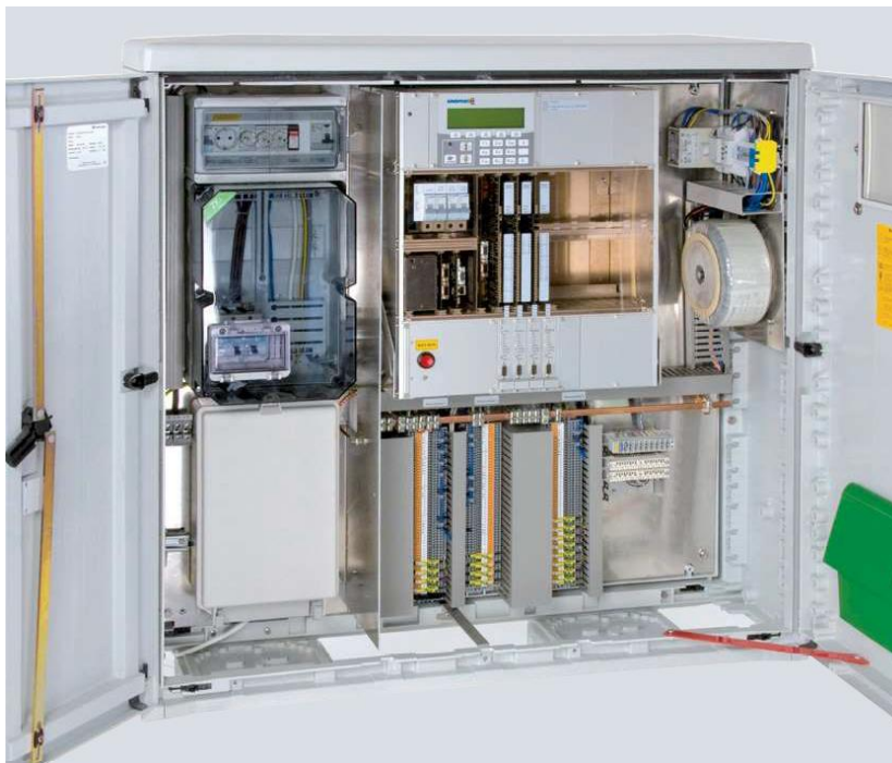
Obr.1 Stávající řadič SSZ
